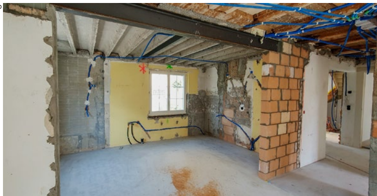
Die Sanierungen erfolgen im unbewohnten Zustand und deshalb etappiert; den Bewohnenden stehen vier Ausweichwohnungen zur Verfügung. Oben Umbau der Wohnküchen, rechts Anlegen neuer Sickerleitungen.
